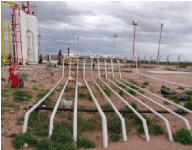
RELEVAMIENTO: CONTROL POST SANEAMIENTO DE UN DERRAME
